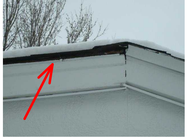
Drip edge missing
